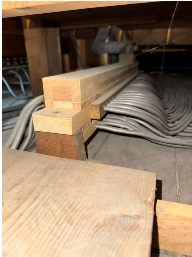
Zwischenrelais im Pedal – unter dem Gangbrett
