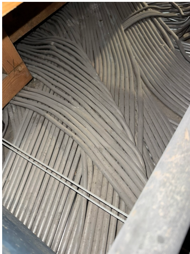
Teilweise stark deformierte Bleirohre zum III. Manual
