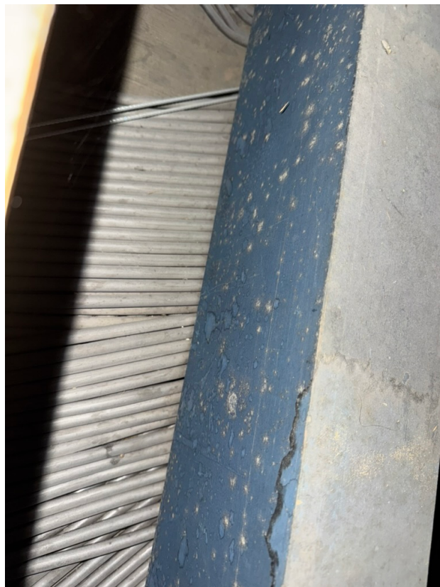
Schimmelbefall an den Kanälen über den Bleileitungen
